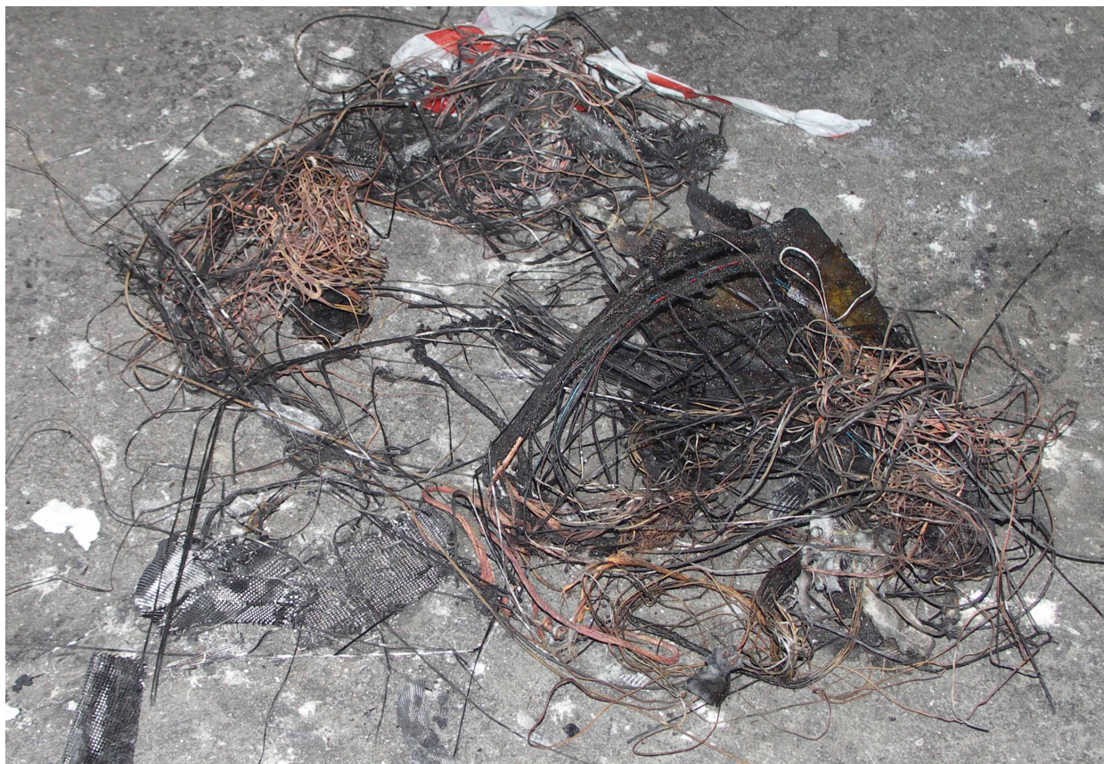
26 – Pozostałości instalacji elektrycznej.
